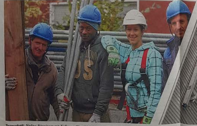
Teamarbeit: Nadine Bönninger mit Kollegen. Obwohl die Männer die 25-Jährige seit Jahren kennen, können sich die meisten immer noch nicht daran gewöhnen, mit einer Frau auf dem Bau zu arbeiten.
